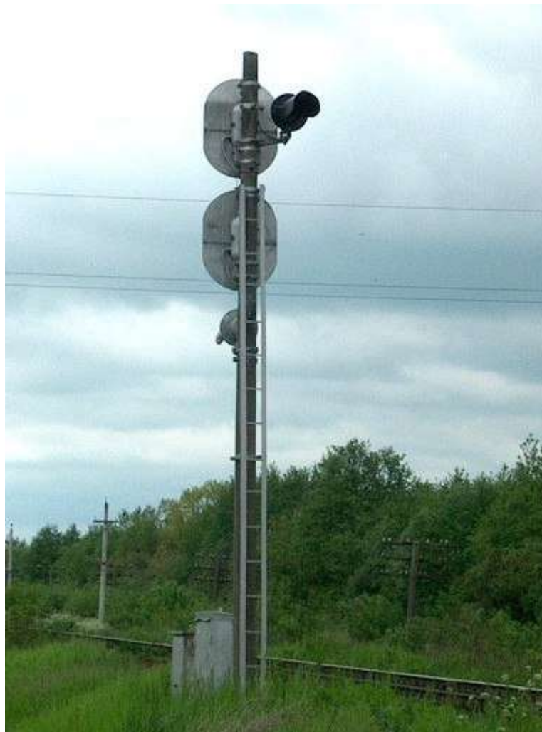
Рисунок 4.93 – входной светофор, на мачте которого в сторону оси железнодорожной станции установлен специальный маневровый светофор
